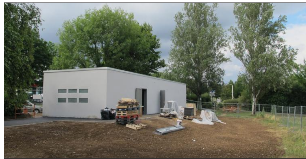
La construction du premier NRO, Nœud de raccordement optique, est sur le point de s'achever à Villefontaine. Photo Le DL/B.D.
